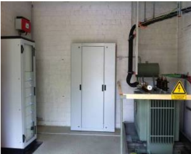
Abbildung 6: Aufstellung einer Batterieanlage in einer 20/0,4 kV-Ortsnetzstation
