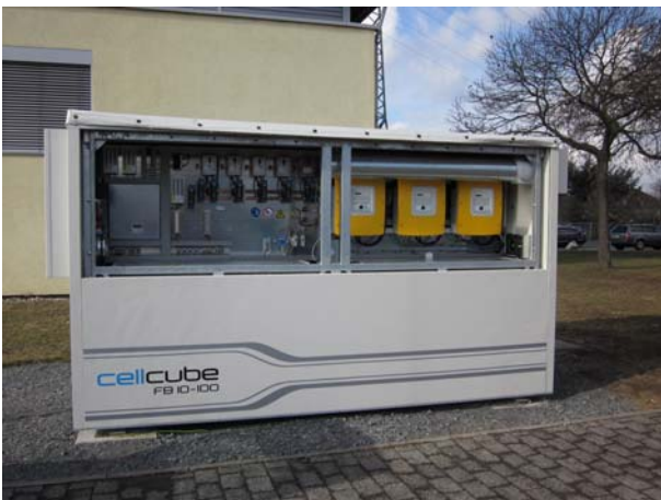
Abbildung 7: Redox Flow Batteriespeichersystem
